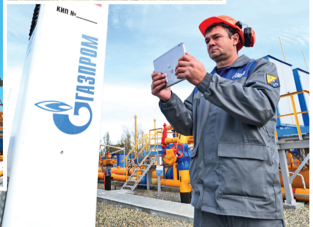
На газораспределительных станциях ООО «Газпром трансгаз Ставрополь» внедрили практику использования компьютерного планшета в повседневной рабочей деятельности, связанной с обслуживанием технологического оборудования. Современная инновационная разработка позволяет эффективно управлять промышленной безопасностью производственных объектов.
