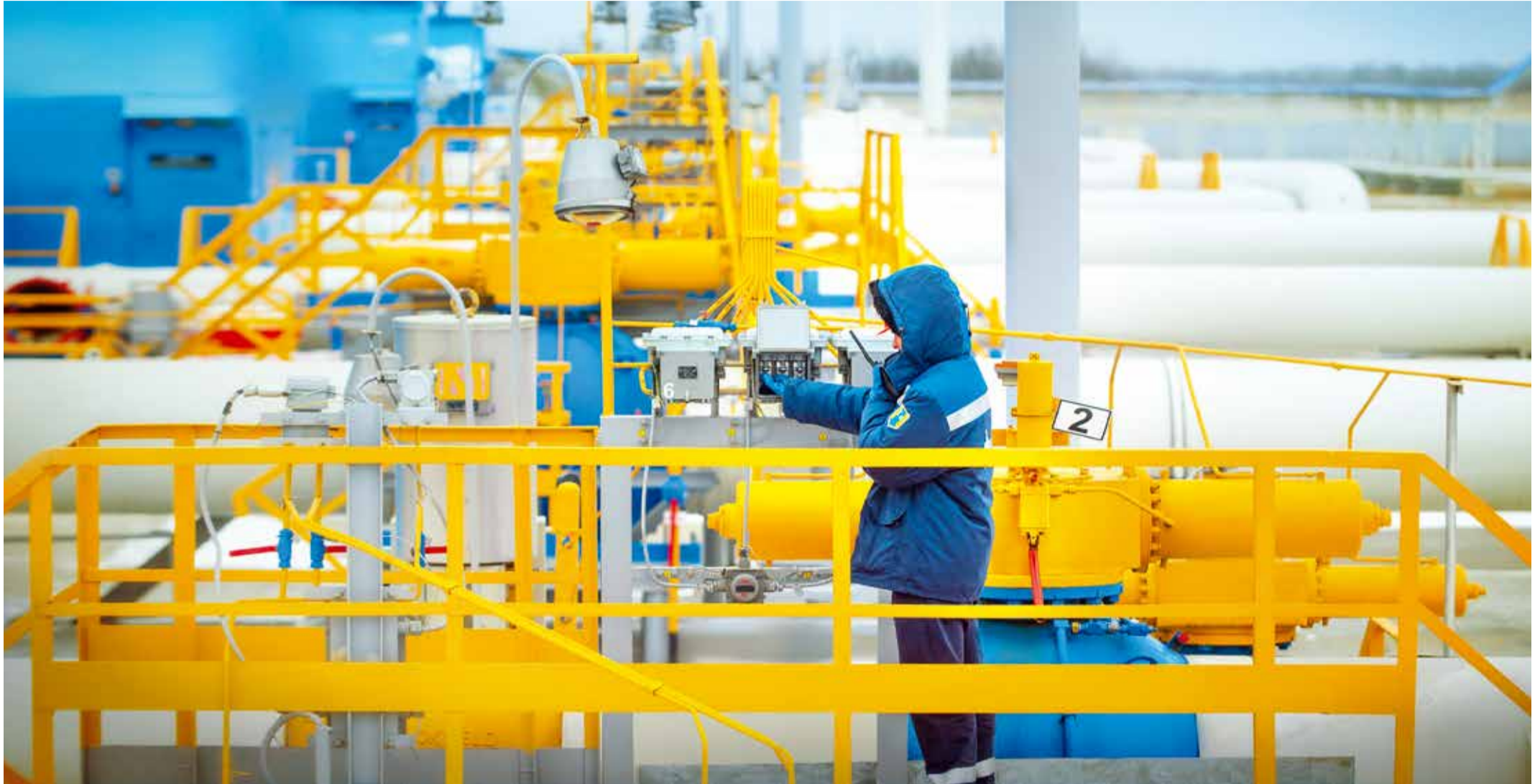
Подготовка к запуску резервного агрегата на компрессорной станции «Сальская»
