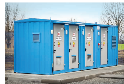
Главной образец блочно-комплектного устройства электроснабжения
