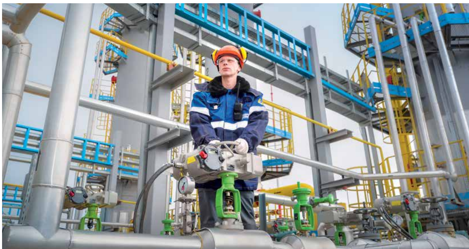
Станция в работе
