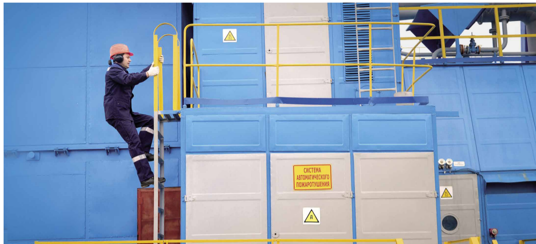
Ежемесячный обход компрессорных цехов ДКС-1
