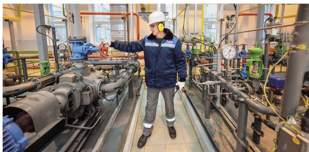
Насосная нового цеха осушки ДКС-2
