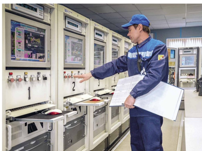
Контроль параметров работы оборудования
