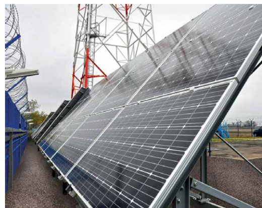
Автономная комбинированная система электроснабжения
