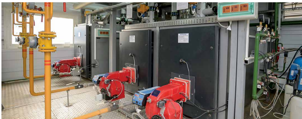
Котельная нового цеха Георгиевского ЛПУМГ
