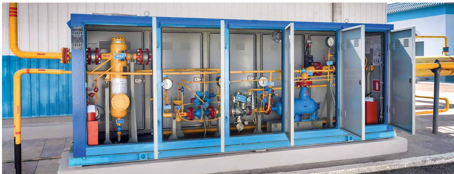
Турбодетандерная установка на ГРС г. Кисловодска
