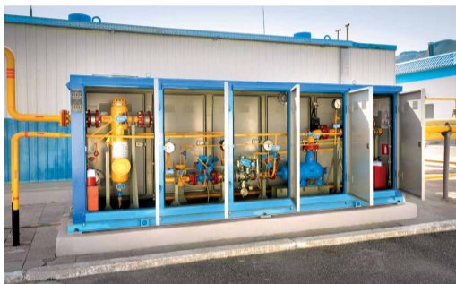
Турбодетандерная установка на ГРС г. Кисловодска
