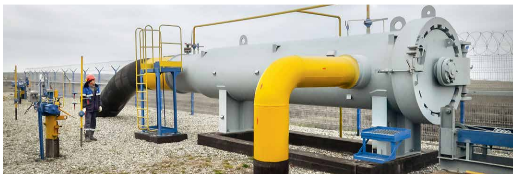
Камера запуска устройств ВТД
