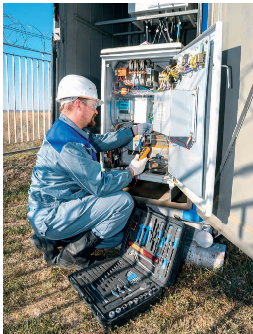
Техническое обслуживание станции катодной защиты
