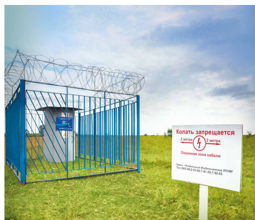
Необслуживаемый усилительный пункт
