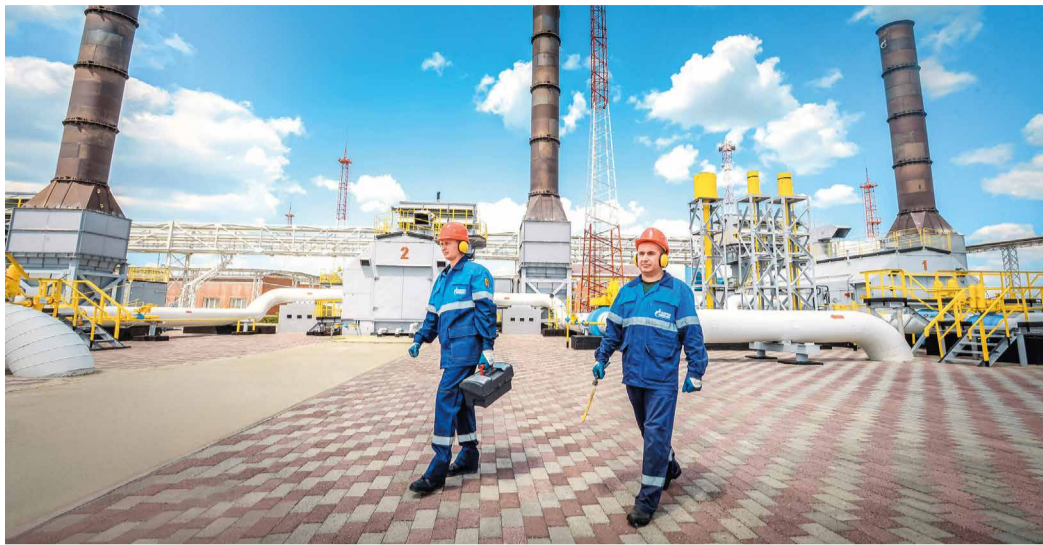
На КС «Ставропольская»
