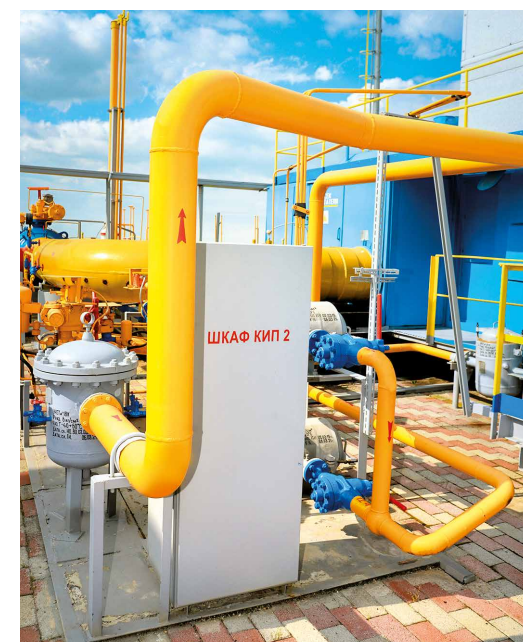
Шкаф с контрольно-измерительными приборами
