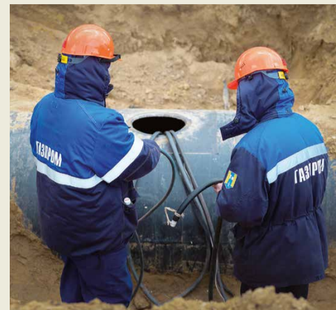
Контроль временного герметизирующего устройства
