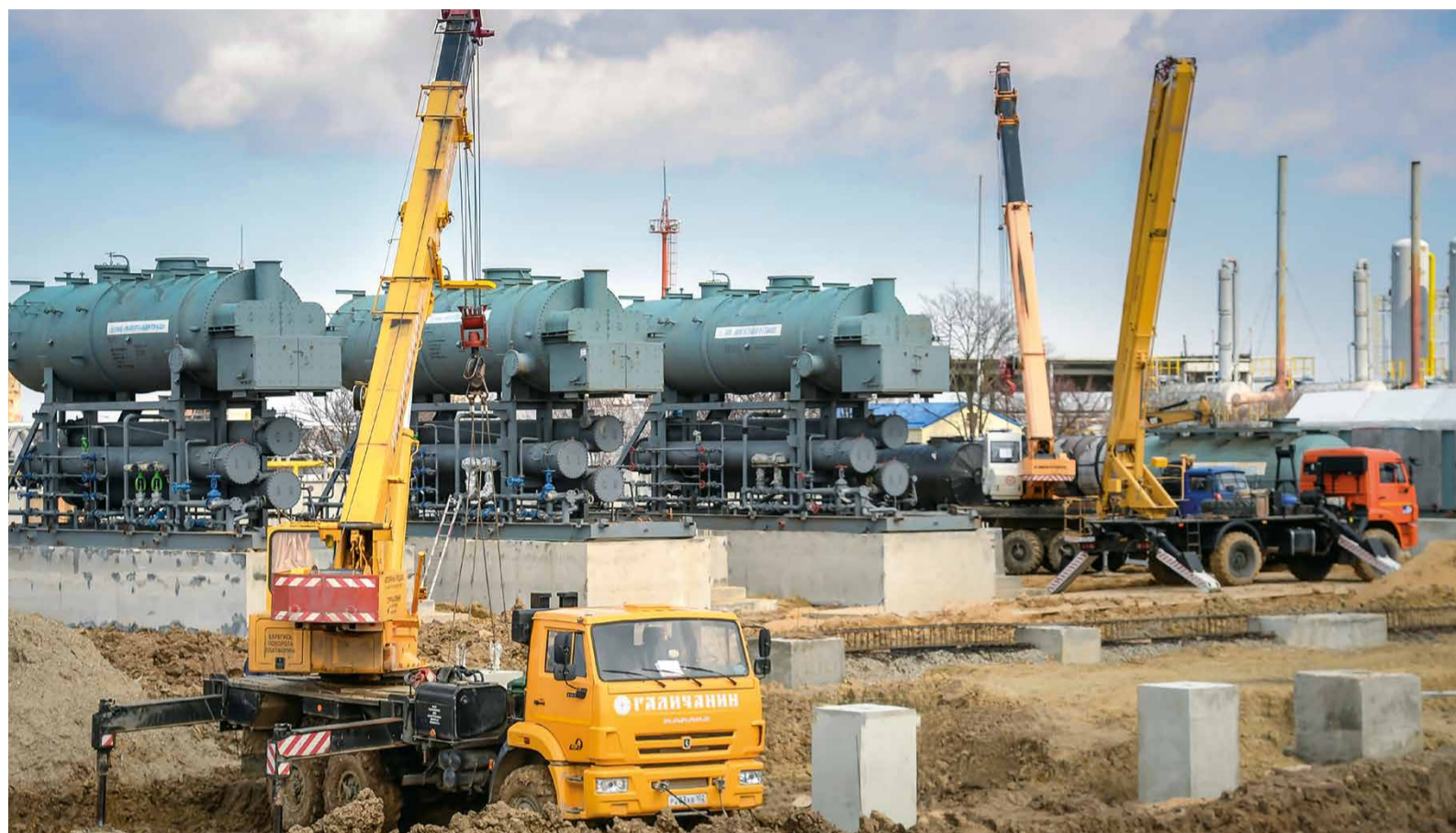
ДКС № 2 вывели из эксплуатации для реализации инвестиционного проекта «Реконструкция газопромысловых сооружений и АСУ ТП Северо-Ставропольского ПХГ».
