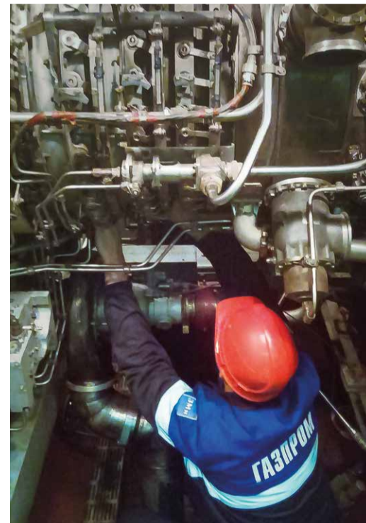
Продление межремонтного ресурса двигателя ГПА
