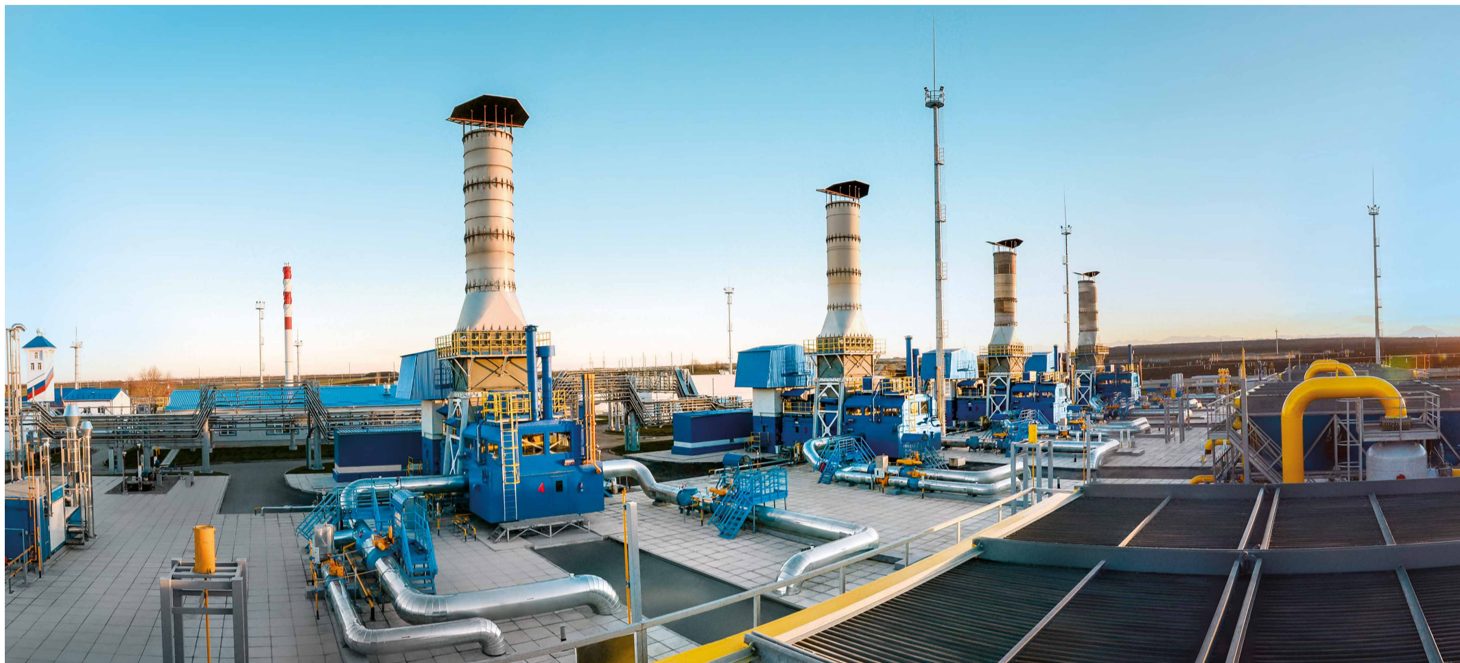
Технологические коммуникации КС «Георгиевск» заполнены газом, оборудование готово к работе в осенне-зимний период
