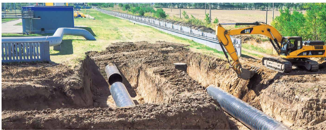
Входные подключающие шлейфы ДКС-1
