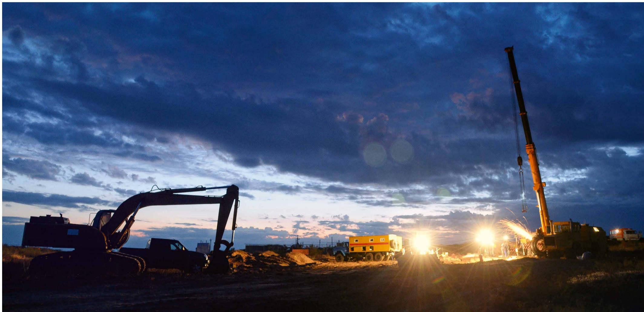
Ночные огневые работы в Зензелинском ЛПУМГ на магистральном газопроводе Макат – Северный Кавказ
