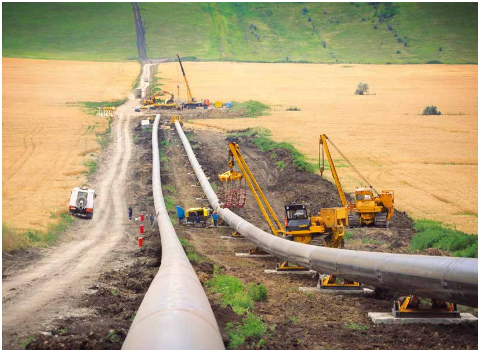
Пятый оползневой участок на трассе строящегося газопровода КС «Изобильный» – Невинномысск
