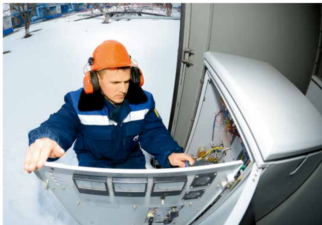
Проверка технического состояния УКЗ
