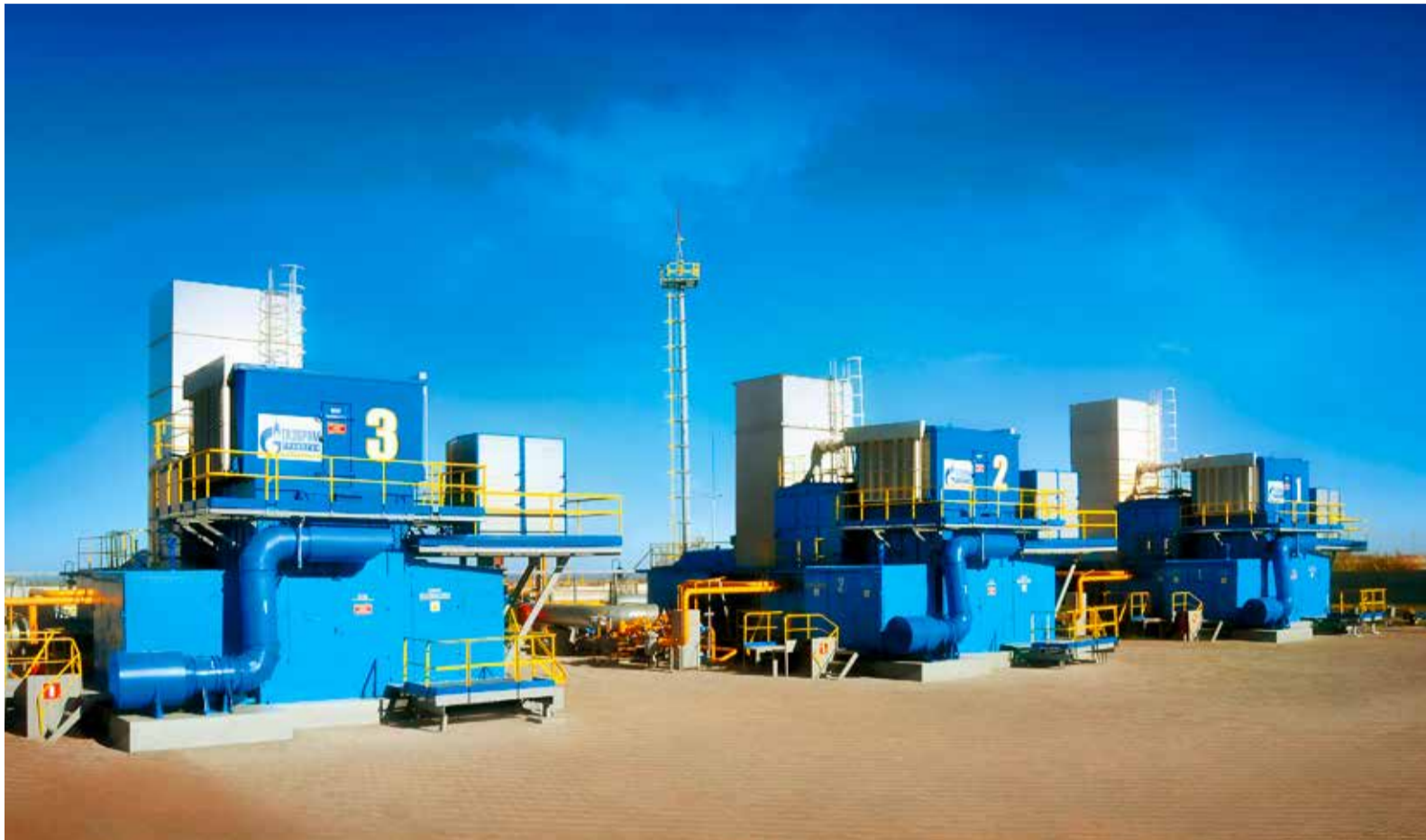
КС-6 «Изобильный» полностью готова к работе
