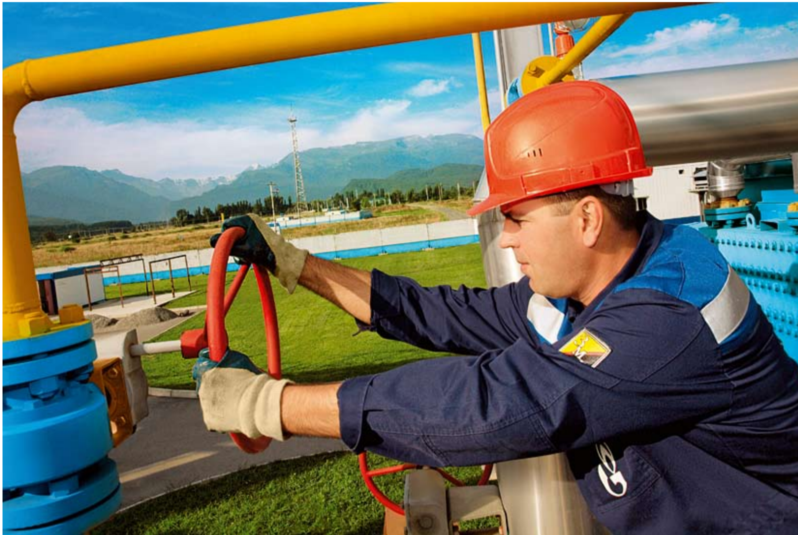
Оператор ТУ Владислав Лагуткин выполняет проверку запорной арматуры технологического оборудования в цехе осушки газа Алагирского РЭП Моздокского ЛПУ МГ
