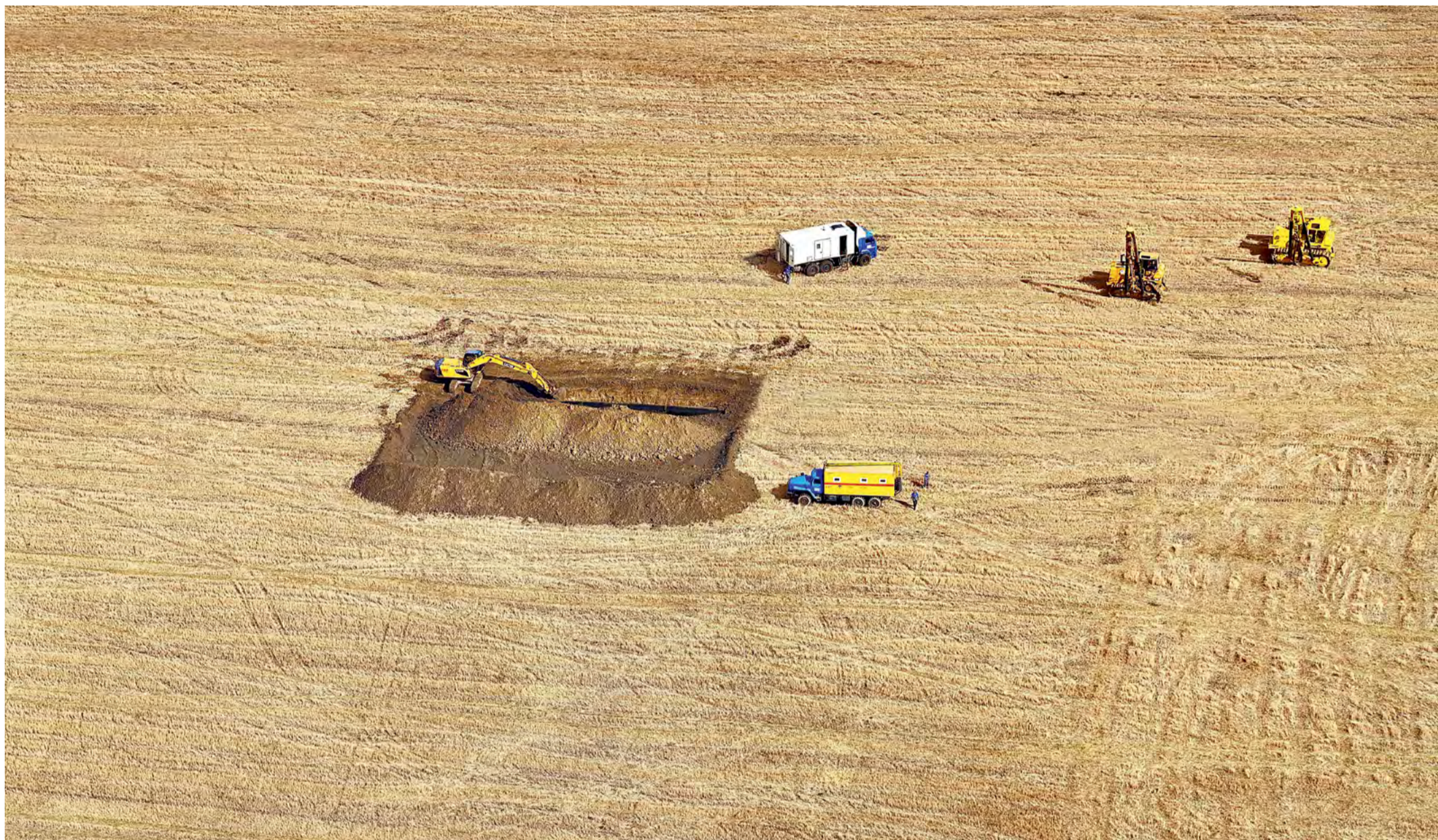
Осенняя пора требует от газовиков оперативности – к зиме нужно успеть завершить ремонтные работы (МГ Невинномысск — Изобильный, 45,5 -75 км)
