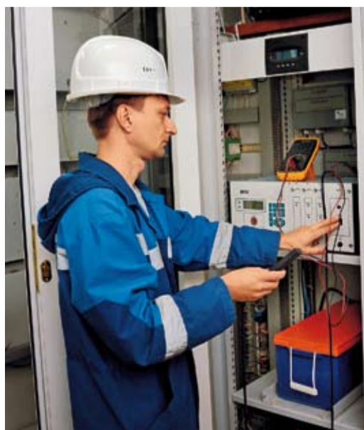
Проверка работы САУ ГРС
