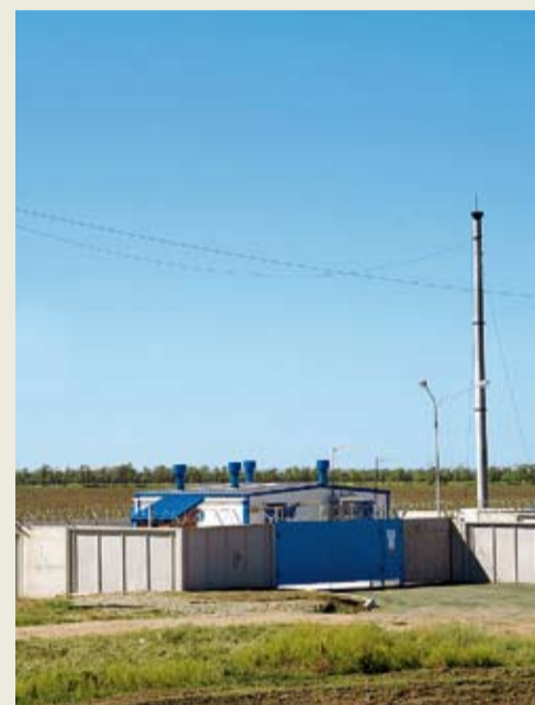
Общий вид площадки ГРС
