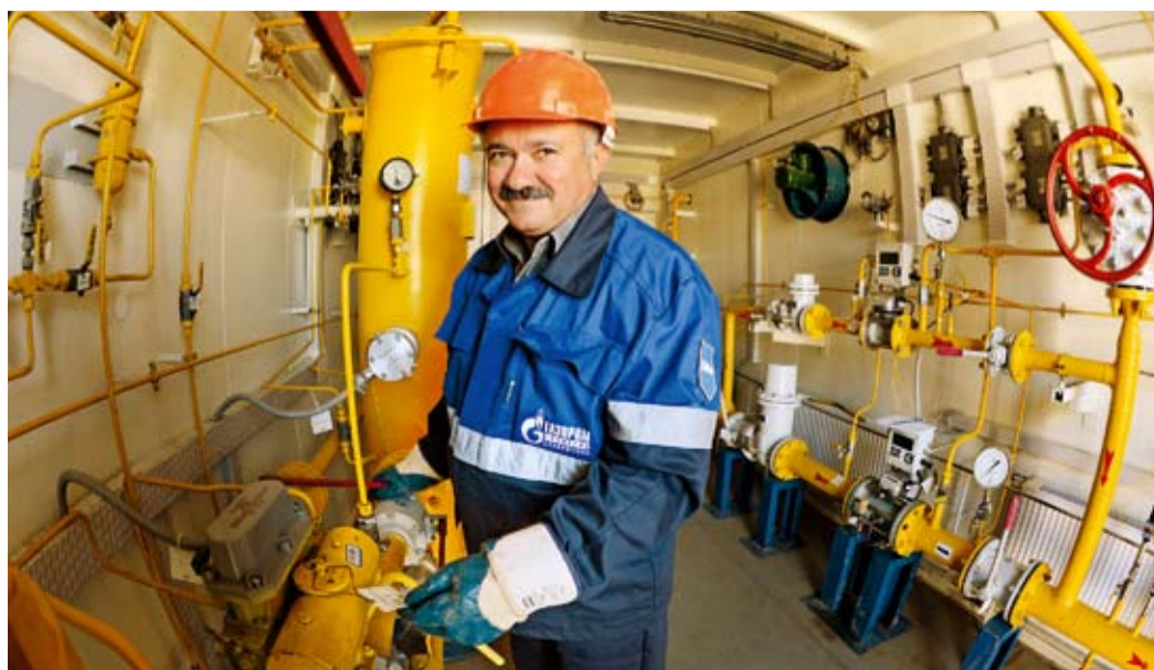
Обслуживание оборудования ГРС
