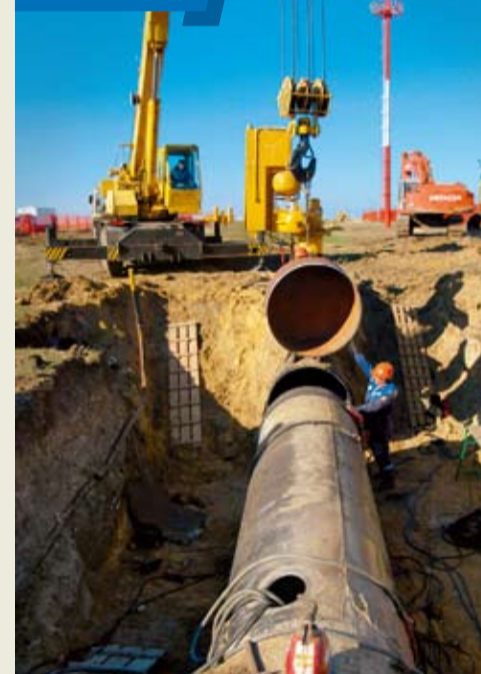
В Изобильненском ЛПУ МГ приступили к капитальному ремонту узла запуска и приема очистных устройств МГ «Новосковск – Аксай – Моздок» с установкой современных камер с байонетным затвором. Это новшество было впервые применено на Юге России
