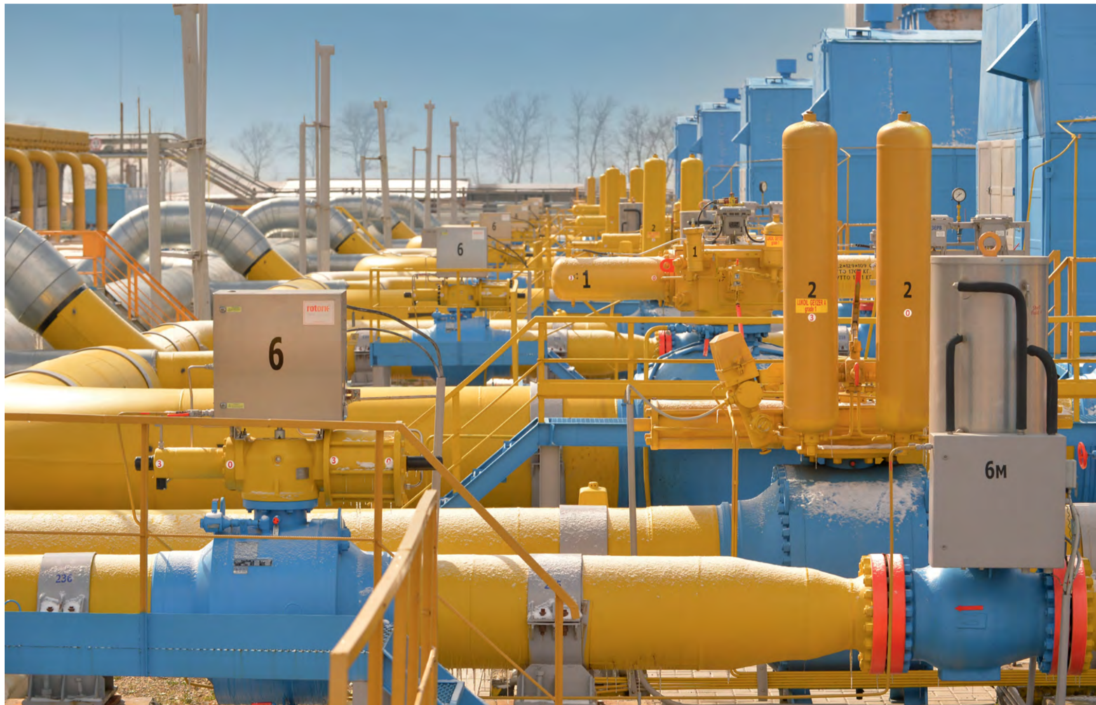
Дожимная компрессорная станция № 1 в работе
