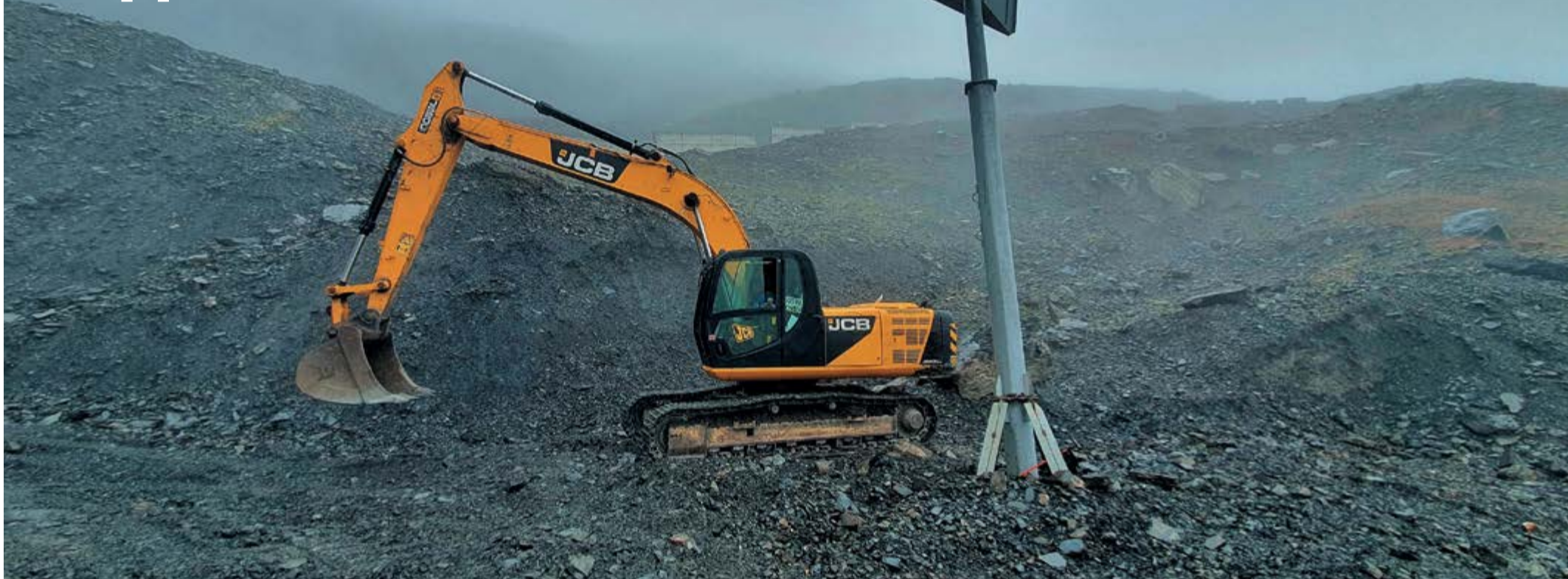
Обустройство площадки для изыскательского бурения на 94 км МГ Дзуарикау – Цхинвал (материал читайте на второй полосе газеты)
