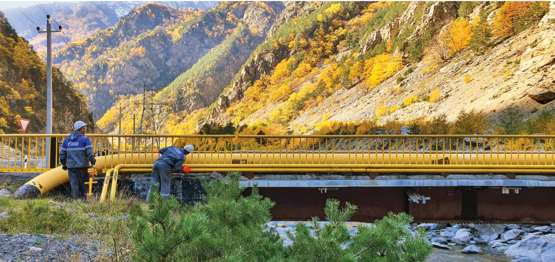
Специалисты ЛЭС и службы связи Моздокского филиала проводят плановый осмотр линейной части магистрального газопровода Дзуарикау — Цхинвал и волоконно-оптической линии связи
